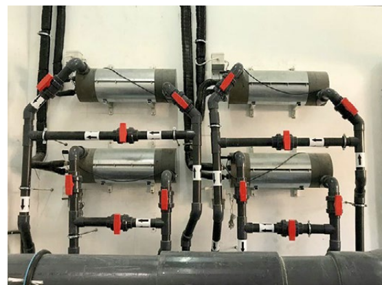
Čtyři tepelné výměníky HP 3000 v provedení SPLIT, Dubaj (140 kW)
