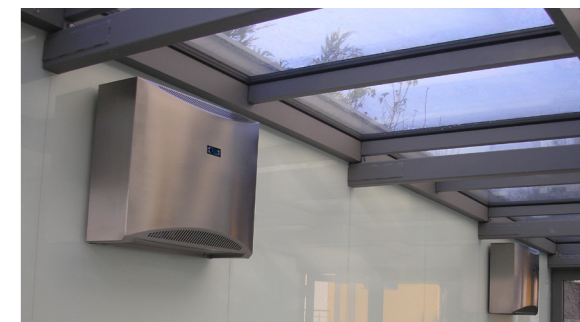
Компактные осушители установлены на стену
