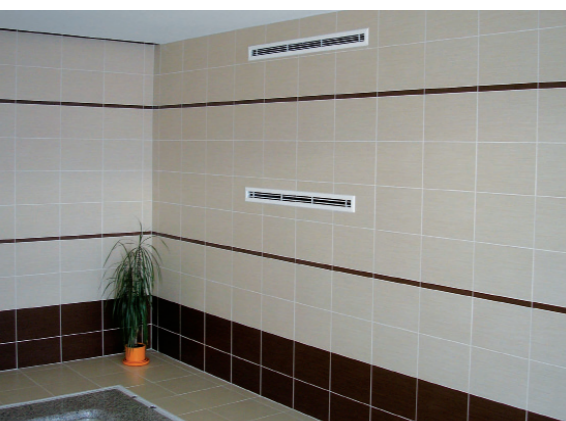
Компактный влагоотделитель установлен позади стены
