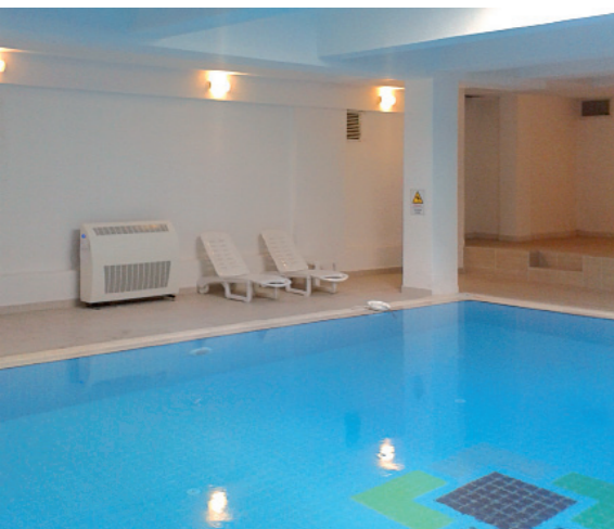
Компактный влагоотделитель установлен на полу
