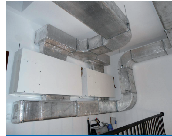
Канальный влагоудалитель установлен в техническом помещении
