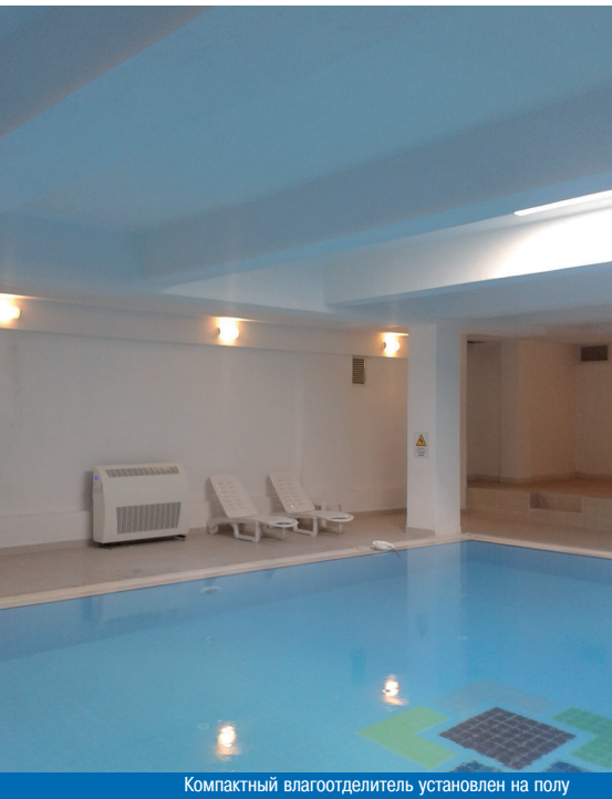
Компактный влагоудалитель установлен на полу
