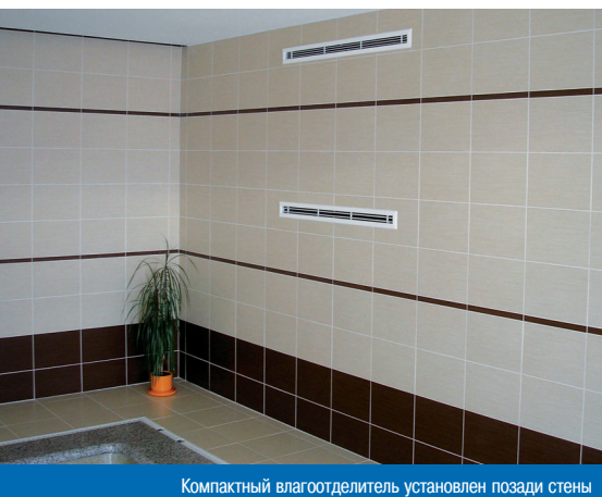
Компактный влагоудалитель установлен позади стены
